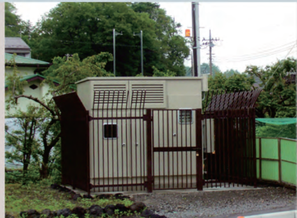
マンホールポンプ施設 Pecc 30
